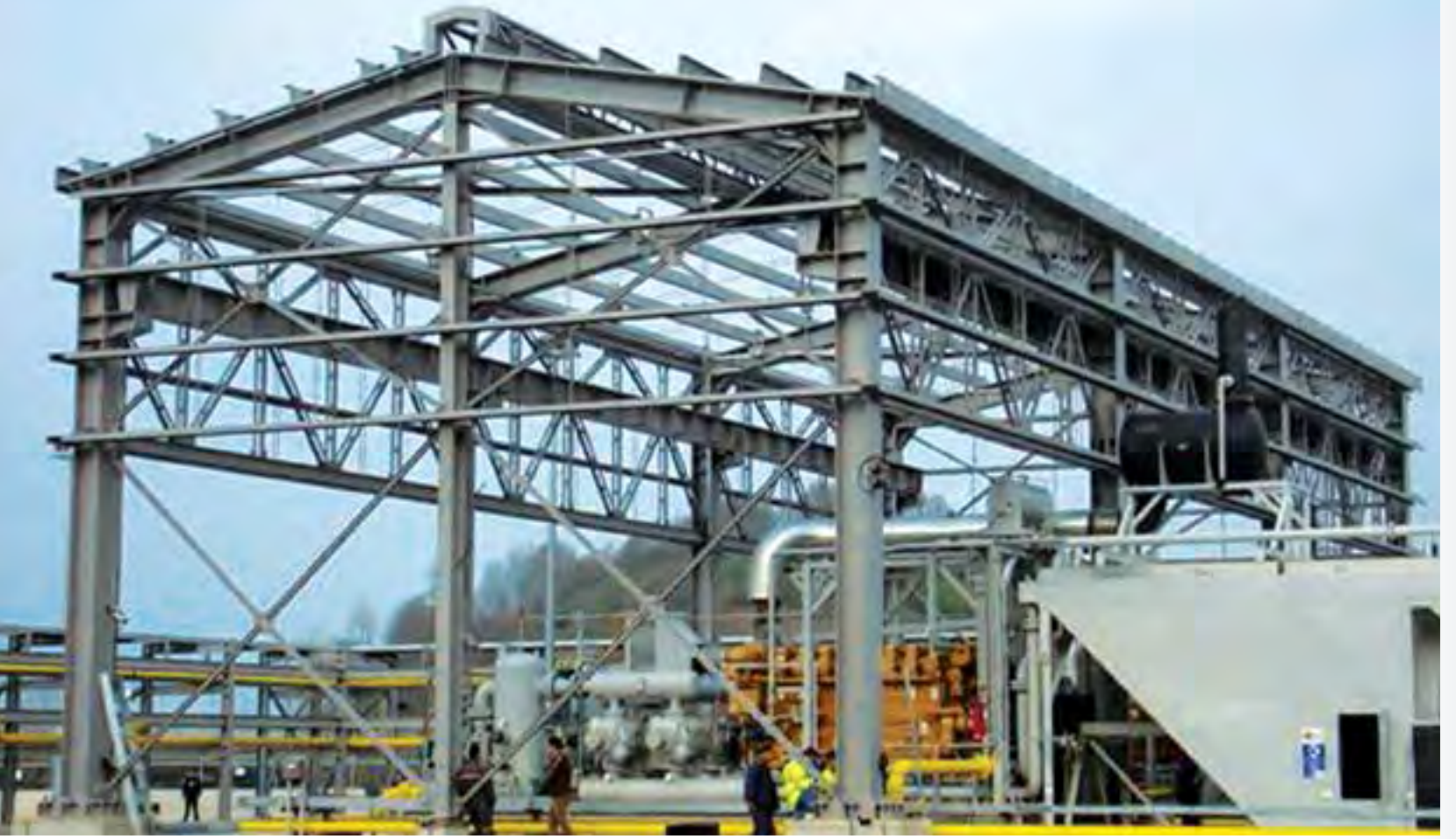
GAMA GÜÇ SİSTEMLERİ Doğalgaz Kompresör Canopy Binaları 200 Ton Akçakoca / EREĞLİ
