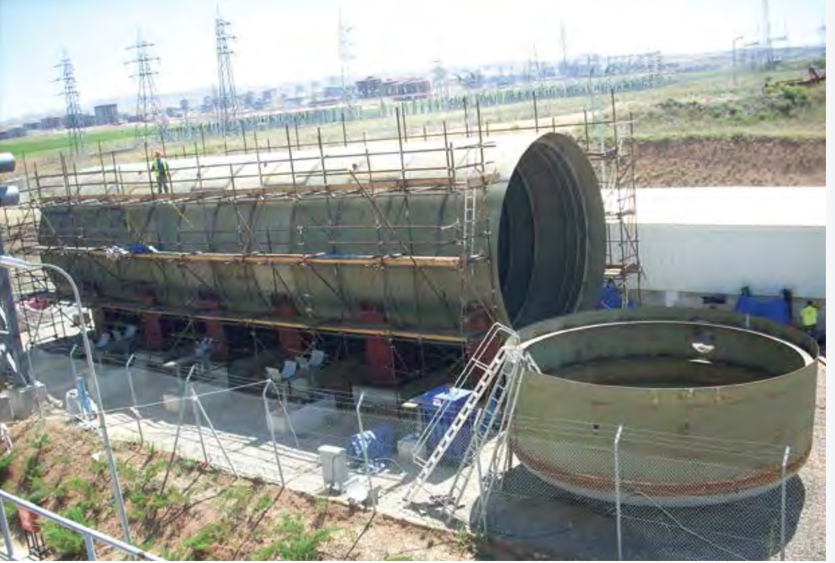
BAYMİNA ENERJİ Doğalgaz Santrali Soğutma Kulesi ve Tankı (1000m 3 ) 500 Ton ANKARA
