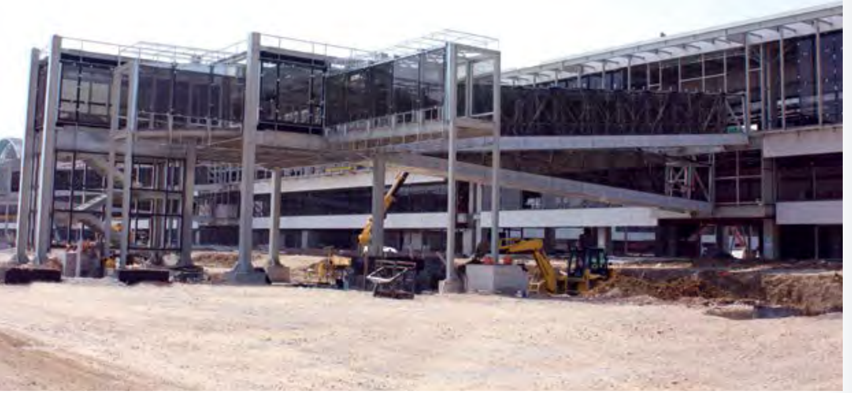
LİMAK-GMR Sabiha Gökçen Havaalanı Yeni Terminal Binası Yolcu Köprüleri 1000 Ton İSTANBUL
